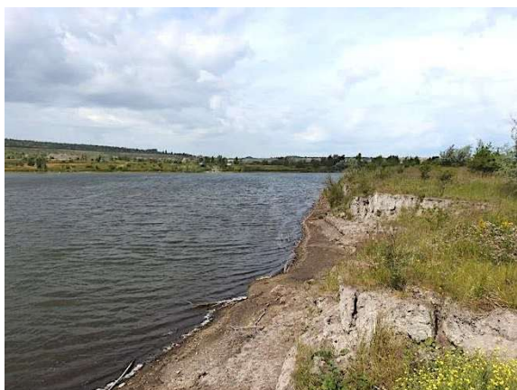
Planbereich des Beckens 6 mit Abbruchkante am Ufer
